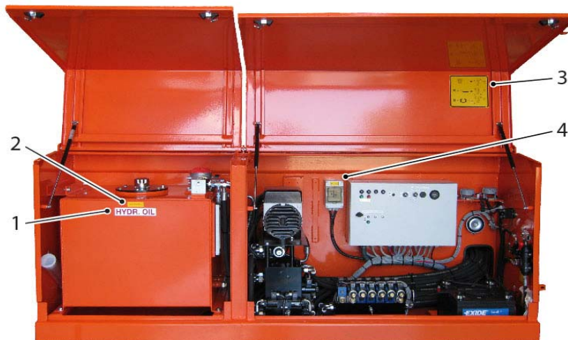
Compartiment d'huile hydraulique et compartiment des soupapes/électricité
